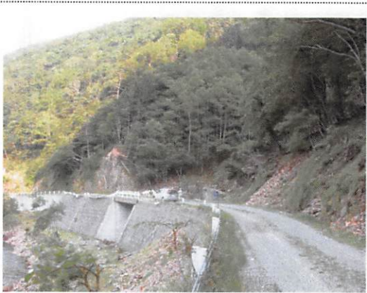
猿留川林道右岸。法面の崩落跡が複数あり、土砂が河川に流れ込んだ跡もある。
