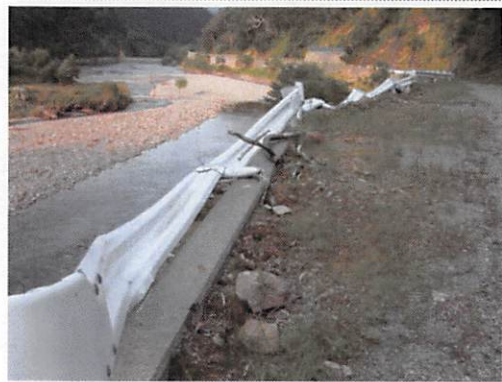
猿留川林道右岸。土砂により押し曲げられたガードレール。
