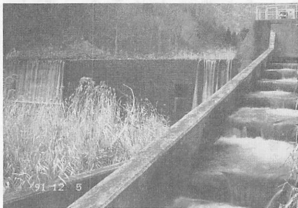
魚道が設置された山間のダム
