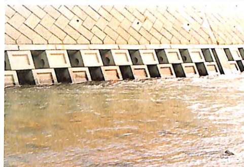
魚の生息、避難などの目的で設けられた魚巢ブロック(真駒内川)
