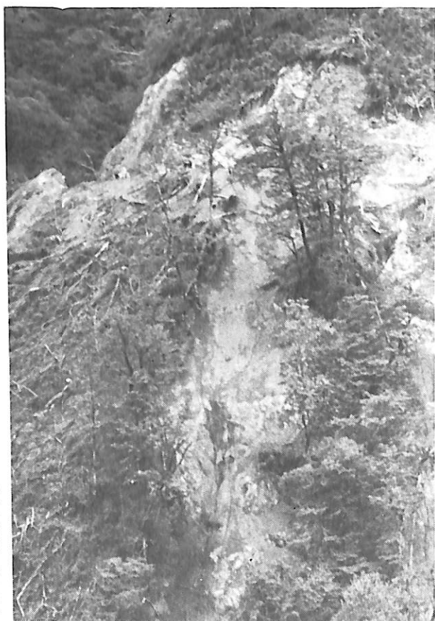
高見ダム建設現場林道付替工事 土砂を沢に投棄している。
