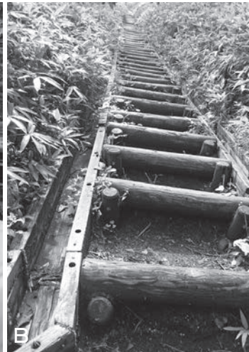
写真5 流水を側方に逃がす横断排水路 (A) と木製側溝 (B) (いずれも八ヶ岳遊歩道)
