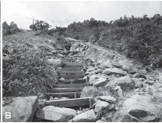
写真4 登山道の側面が洗掘した擬木丸太階段 (A: 山梨県瑞牆山、B: 尾瀬至仏山)
