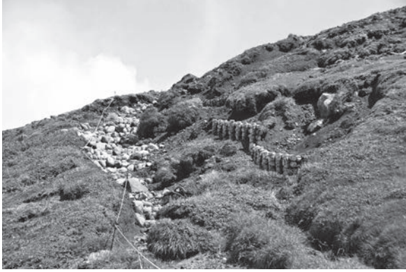
写真1. 中岳温泉-中岳分岐間の円石を使用した床止工（石積工）と木柵土留工
