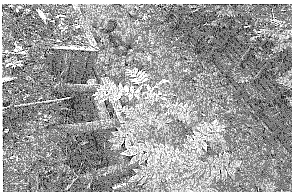
写真7 厚沢部町民の森・畑内川の木柵護岸区域の修復後。河床はコンクリートから土と石に戻され、木柵護岸にはニホンザリガニの流下に備えてスロープ(写真手前左)を設けた。河床や河岸にはサワグルミの稚樹が進出し生態系の回復が進んでいる。(2013年)
