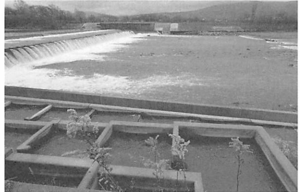
写真 20 旧花園頭首工の新(奥)旧(手前)魚道(2011 年 11 月)
