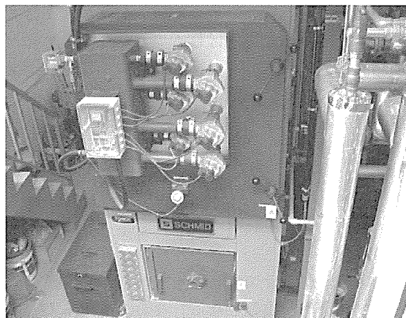
写真4 五味温泉に導入されている温水ボイラー
