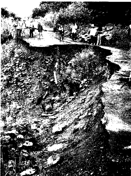
写真5 平取・えりも線の大規模林道崩壊地
