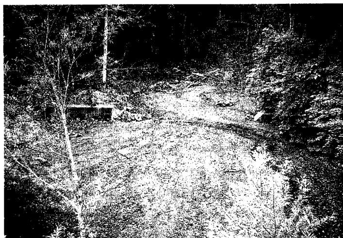
写真4 土砂で完全に埋まった砂防ダム
