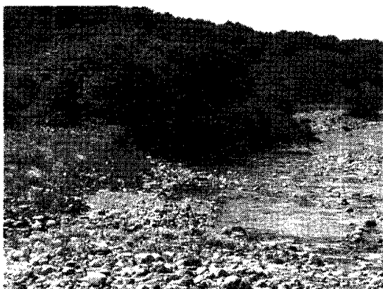
写真1 道南熊石町見市川の川岸崩壊・木が倒れ込んでいる
