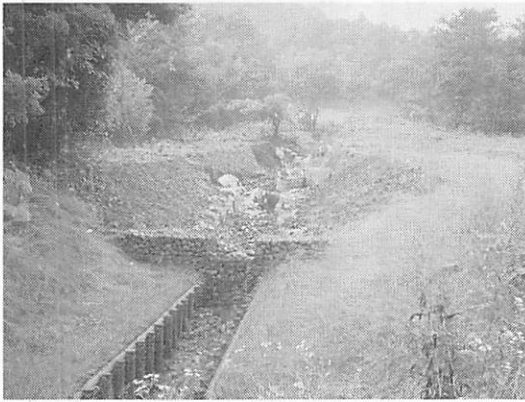
平取・新冠区間(復旧後も崩壊は進む)
