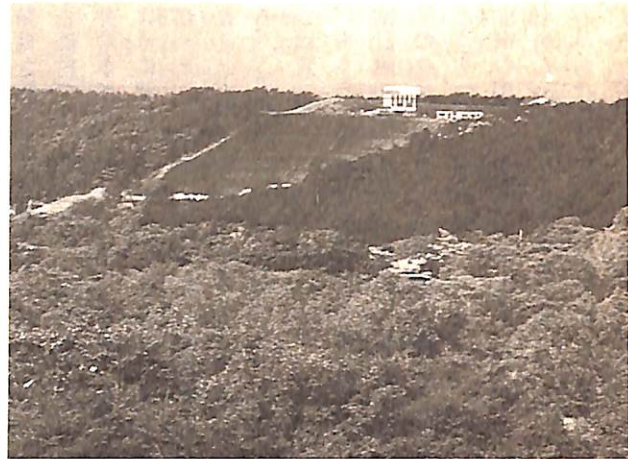
千歳市内のゴルフ場建設現場、急斜面の法面工事をしている
